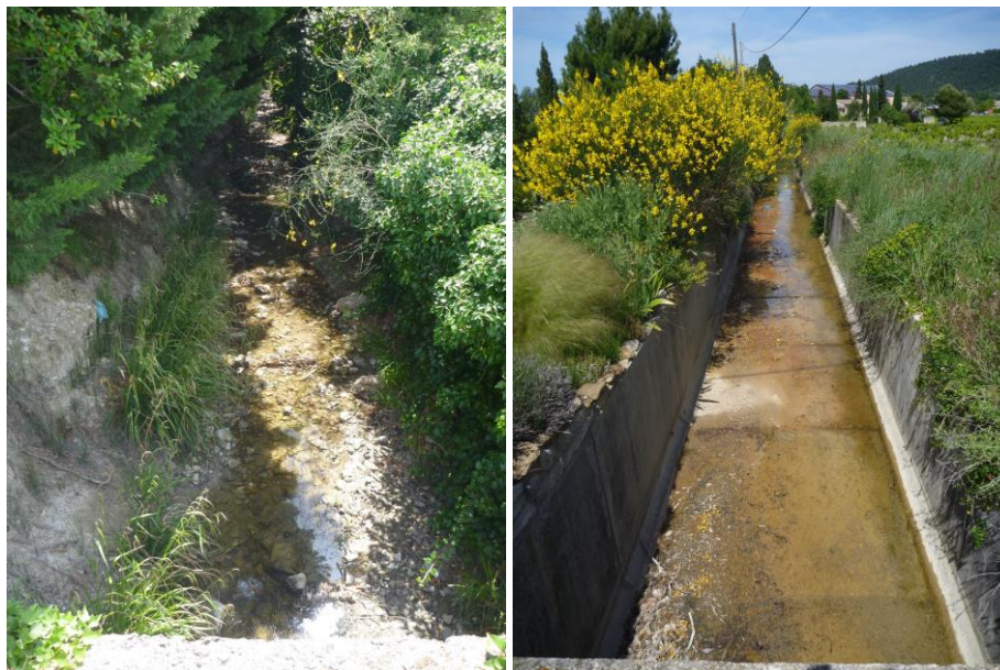
Figure 18 : Vues du réseau sur le chemin des Grands Vallats au niveau de son exutoire
