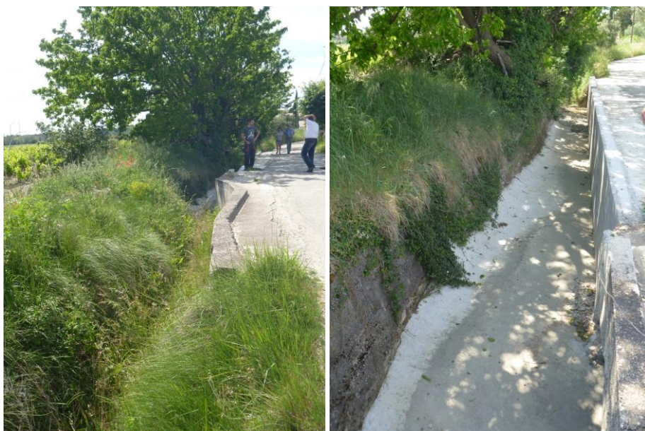
Figure 25 : Vues du réseau au niveau du Rieu de Saint Jean, sur le chemin des Quatre Ponts
